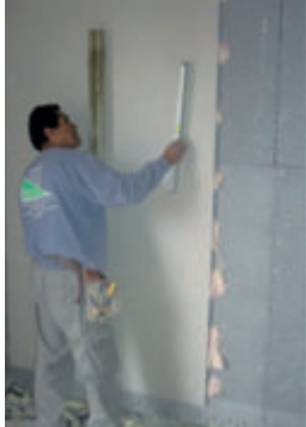
Figure 43.- Fixation de la plaque de plâtre et vérification de niveau. (Source: ANAPE)
