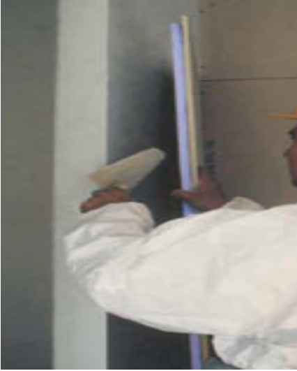
Figure 38.- Isolation par l'intérieur avec du XPS et une plaque de plâtre (Source: AIPEX)
